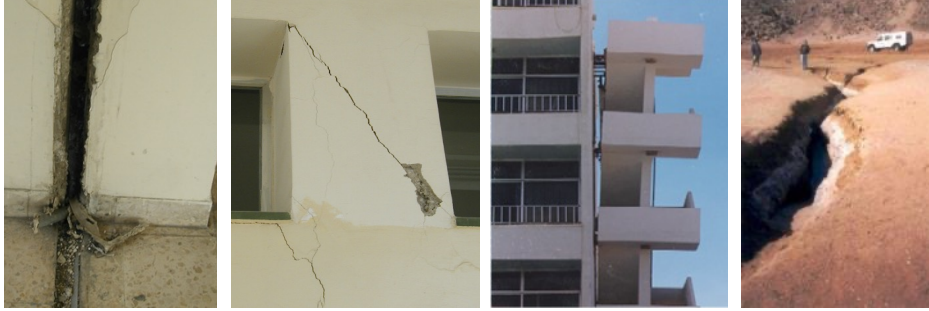
الشكل 5: بعض الصور التي تبين الأضرار التي تسبب بها زلزال 1995 - 2004 ▲
